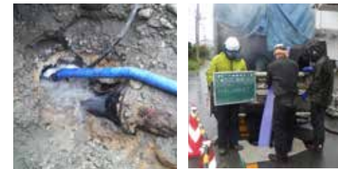
▲腐食した下水道管
